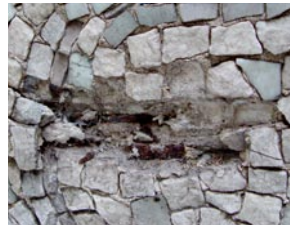
L'oxydation des armatures en fer faisait par endroit éclater le mortier de pose et provoquait la perte de tesselles
